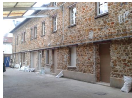
Cour de récréation et locaux du primaire, 34 rue Rémilly avant travaux en 2014
